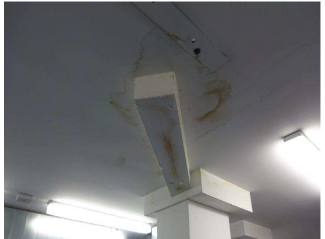
foto/3/ Pohled na vlhkostní poruchy
