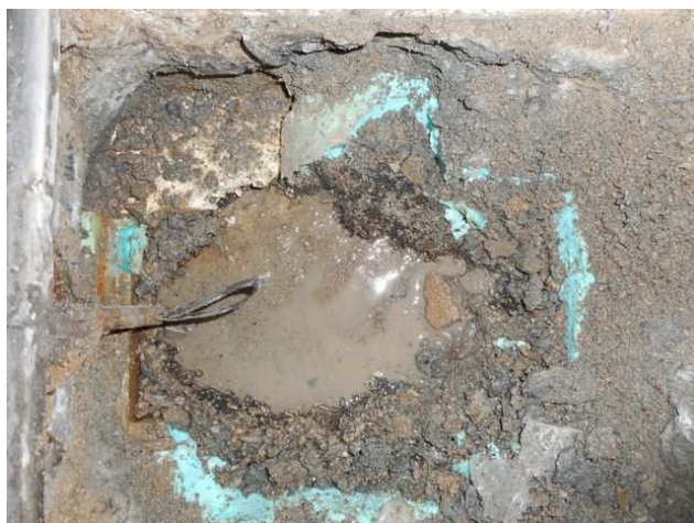
foto/28/ Pohled na zabudovanou vodu ve skladbě terasy u odvodňovacích žlabů – již po odtečení hlavní části vody
