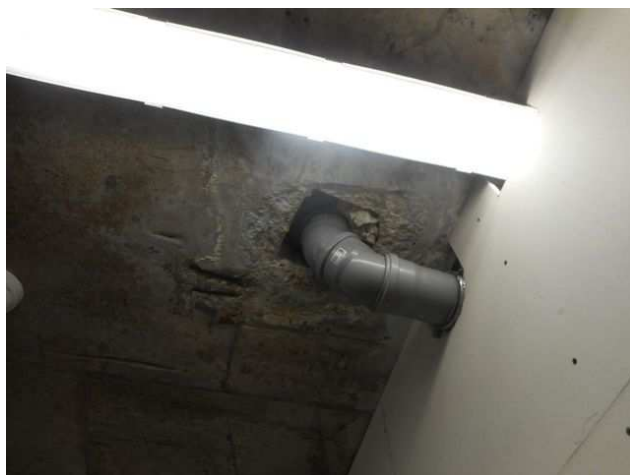
foto/7/ Pohled na vlhkostní poruchy na stropě pod terasou
