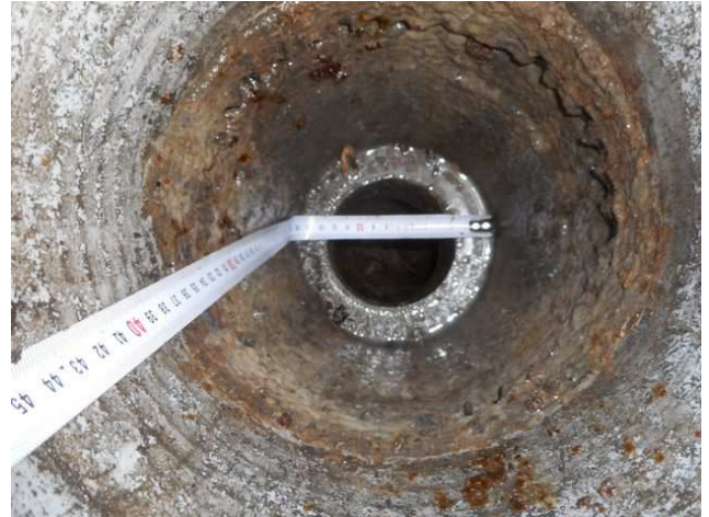
foto/22/ Pohled zanesení vtoku cementovým mlékem a průměr vtoku
