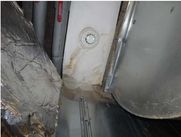
foto/2/ Pohled na vlhkostní poruchy na stropě pod terasou
