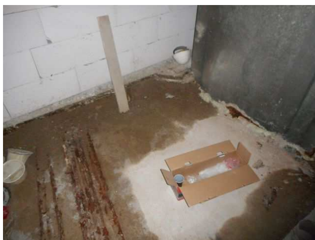
foto/10/ Pohled na vlhkost na podlaze v technické místnosti
