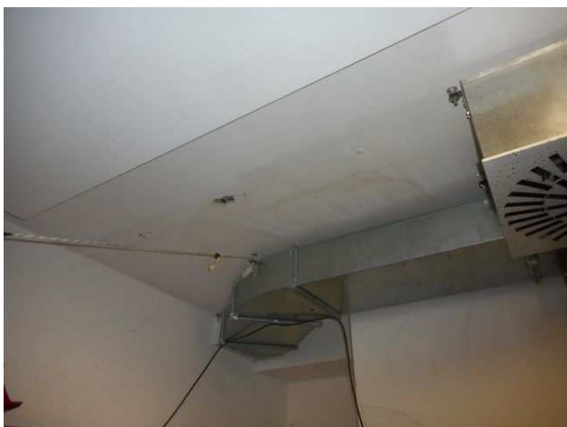
foto/6/ Pohled na vlhkostní poruchy na stropě pod terasou
