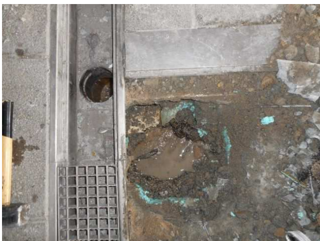
foto/27/ Pohled na zabudovanou vodu ve skladbě terasy u odvodňovacích žlabů – již po odtečení hlavní části vody
