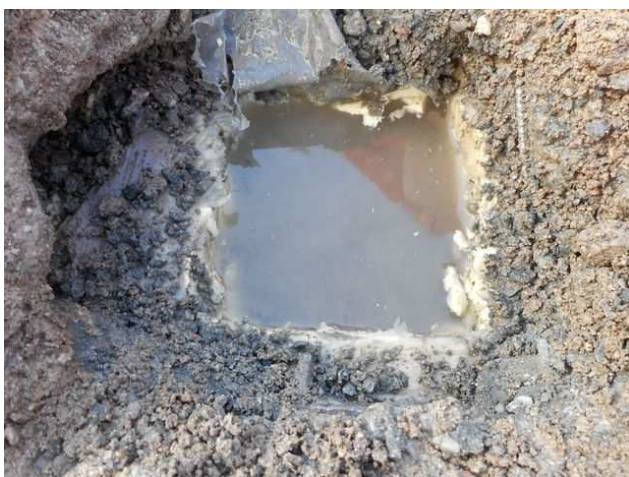
foto/15/ Pohled na zabudovanou vodu uvnitř skladby terasy
