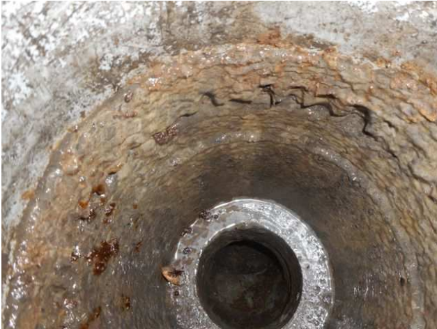
foto/21/ Pohled zanesení vtoku cementovým mlékem
