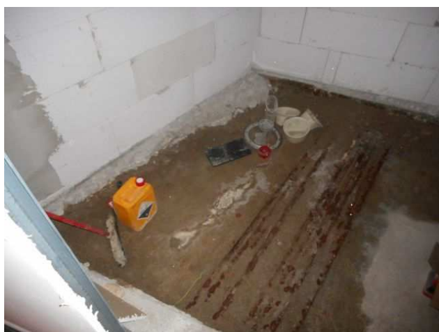
foto/9/ Pohled na vlhkost na podlaze v technické místnosti
