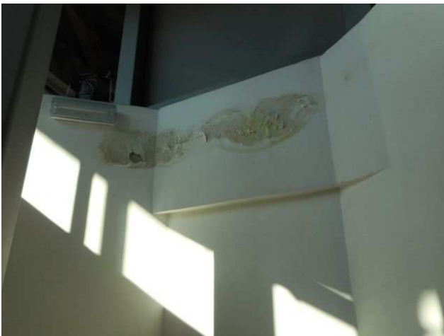
foto/4/ Pohled na vlhkostní poruchy
