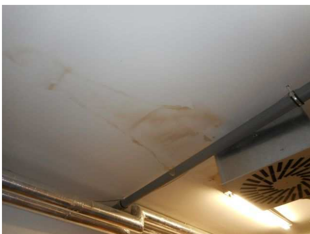
foto/8/ Pohled na vlhkostní poruchy na stropě pod terasou
