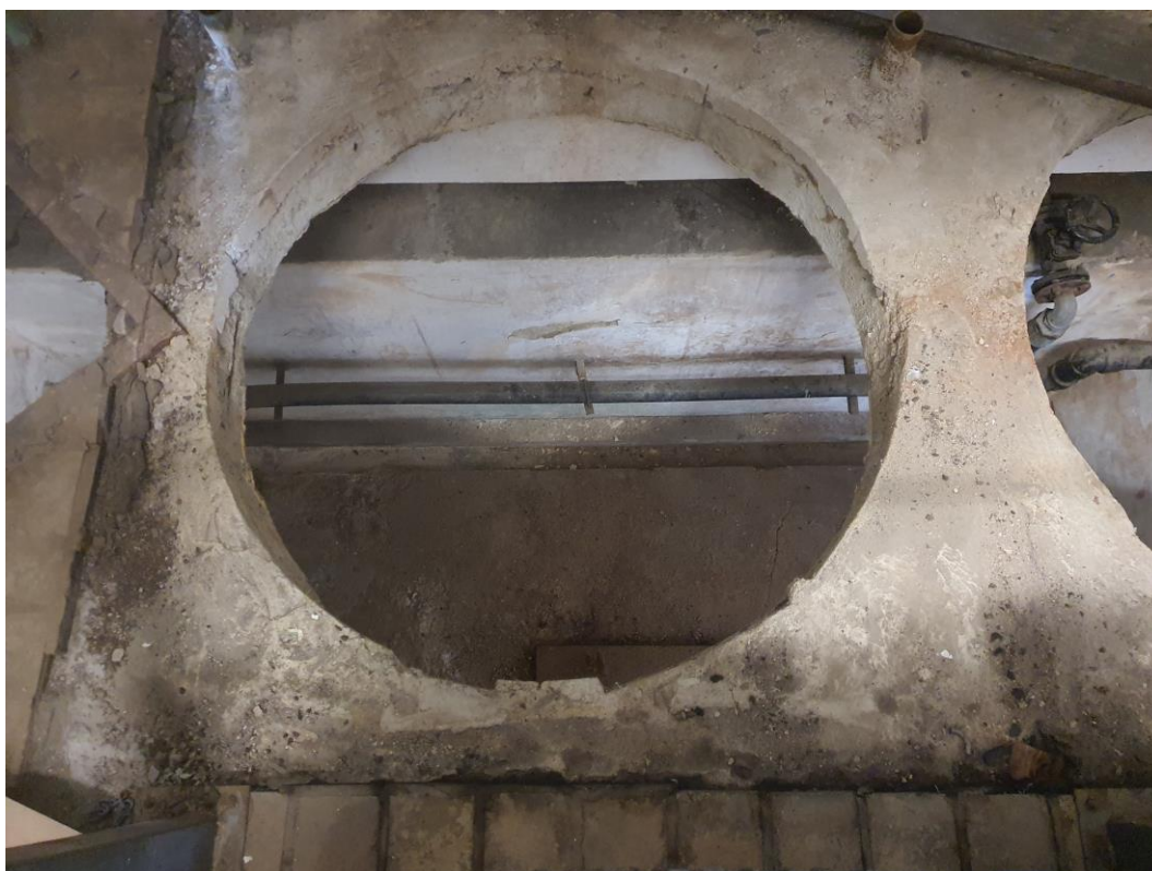
Fotografie č. 12 – Prostor před skladem chemie MPSL – díry
