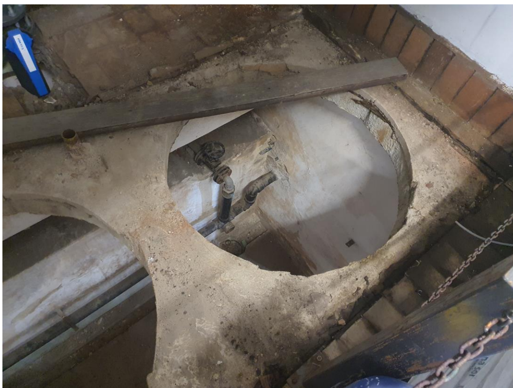
Fotografie č. 10 – Prostor před skladem chemie MPSL – díry
