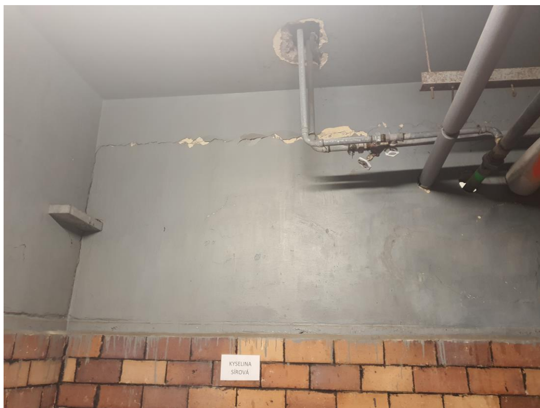
Fotografie č. 4 – Sklad chemie MPSL
