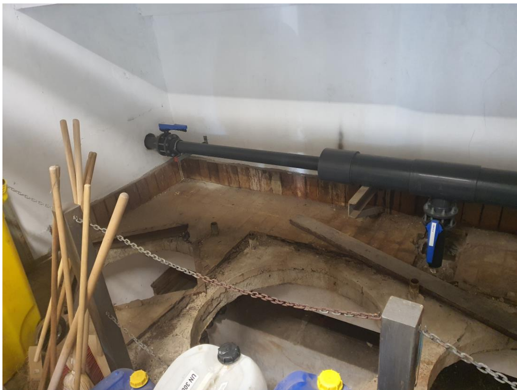
Fotografie č. 11 – Prostor před skladem chemie MPSL – díry
