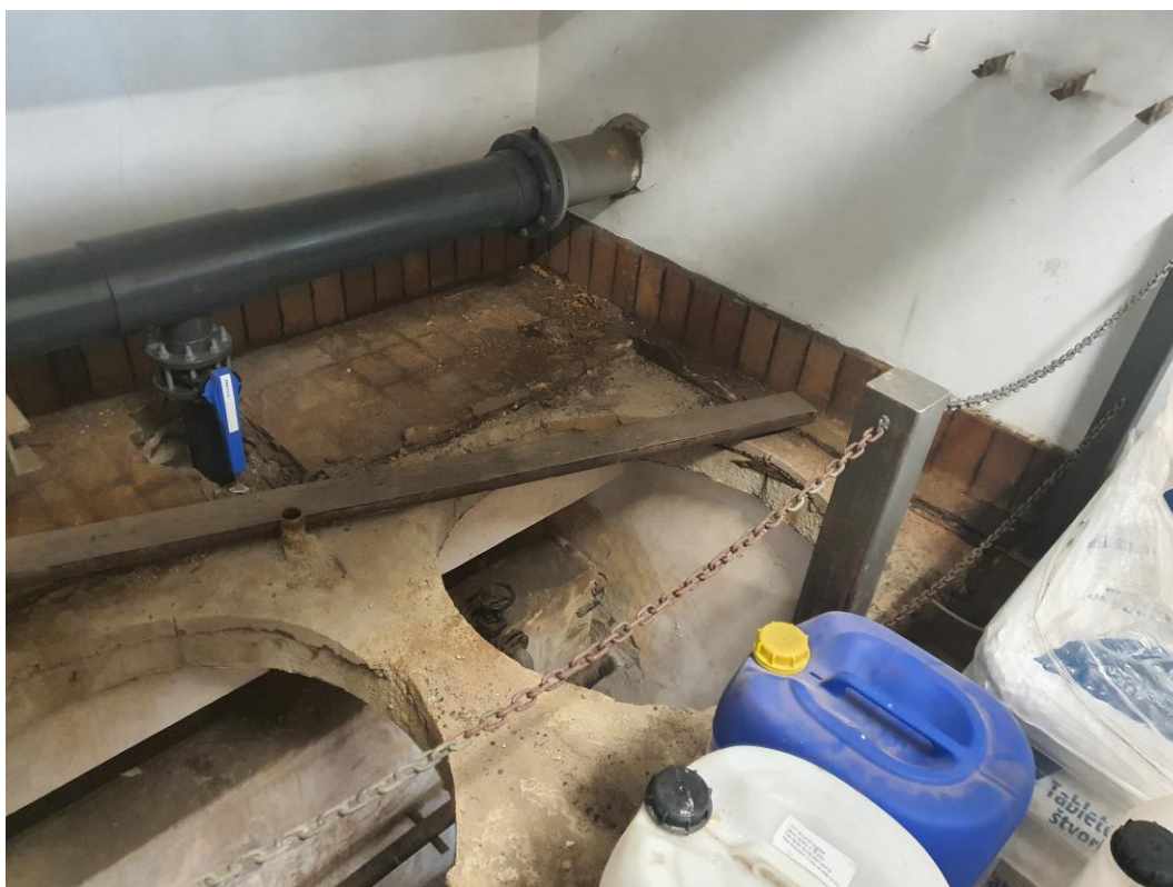
Fotografie č. 9 – Prostor před skladem chemie MPSL - díry
